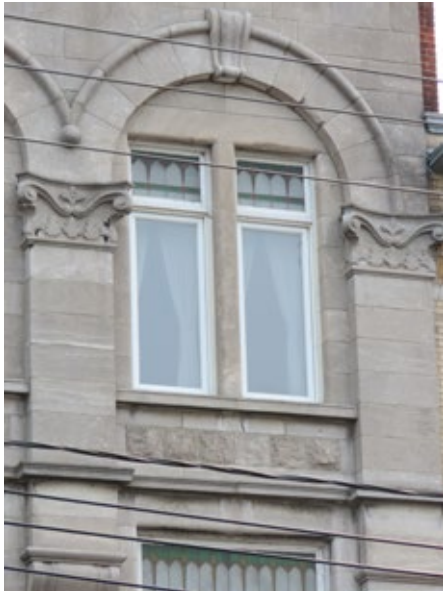
Arc plein cintre en pierre de taille, reposant sur des pilastres et surmontant deux fenêtres jumelées à imposte. 211-215, rue Victoria, Salaberry-de-Valleyfield.
