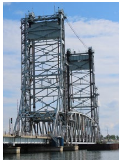
Le pont Larocque doté d'une structure de type en poutre en treillis avec tablier inférieur. Ses deux tours permettent de hisser la structure centrale afin de permettre le passage des bateaux. Il surplombe le canal de Beauharnois entre Salaberry-de-Valleyfield et Saint-Stanislas-de-Kostka.
