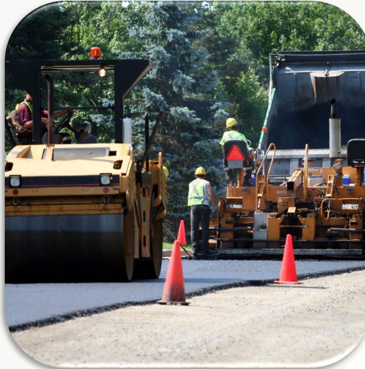
Infrastructures de surface
